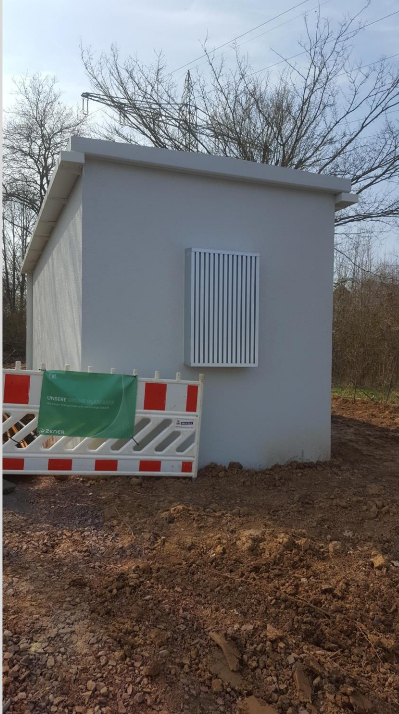
PoP-Station FCB-Indoor mit AirMaze über Lufteinlass
